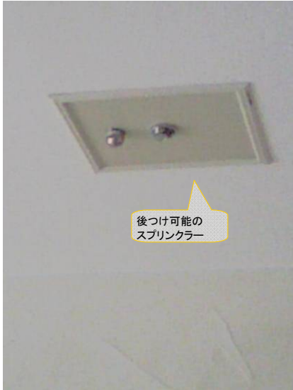
天井にはホームスプリンクラー設置
