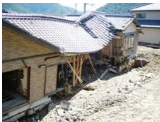
図 5 佐用町久崎の被災状況（浸水深 1.8m）
